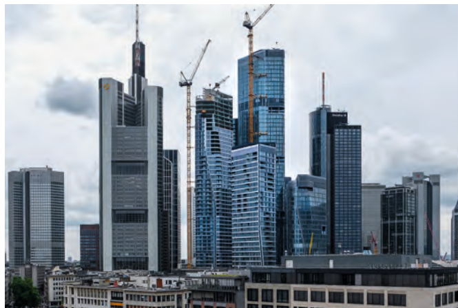
Bild 17 Die FOUR Baustelle inmitten der Skyline (Ende Mai, 2024) (Quelle: FOUR Frankfurt, webcam) The FOUR construction site in the middle of the skyline (end of May, 2024)
